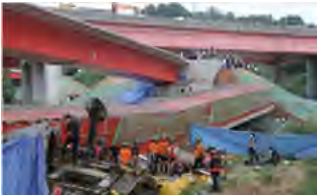
2013年韩国榜花大桥施工时发生事故而垮塌
